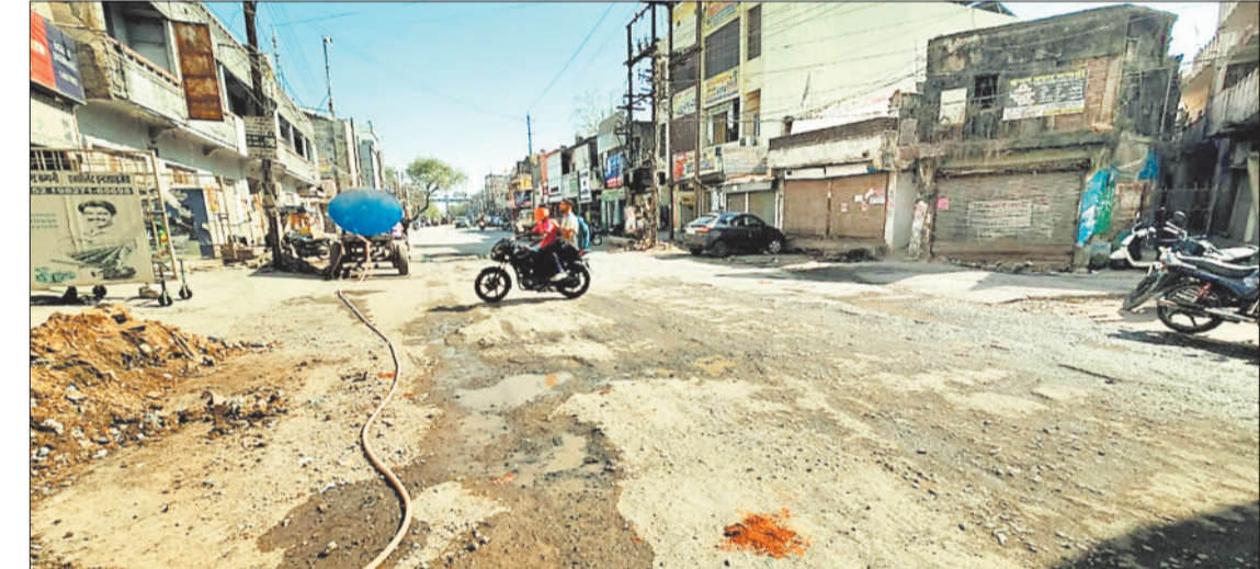
जूना बिलासपुर से दयालबंद जाने वाली सड़क पर धीमी गति से चल रहा निर्माण कार्य।
